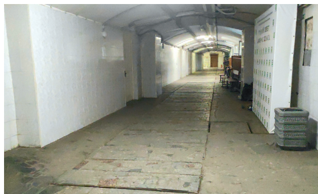
Подвальный этаж для приборов отопления (фото И. А. Кузнецовой, 2024 г.)
