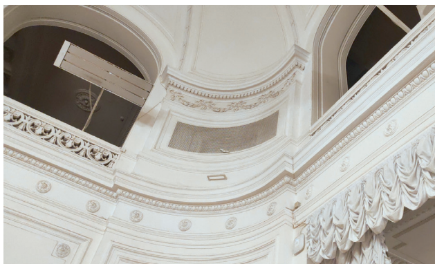
Вентиляционная решетка в потолочном своде Белого зала (фото И. А. Кузнецовой, 2023 г.)
