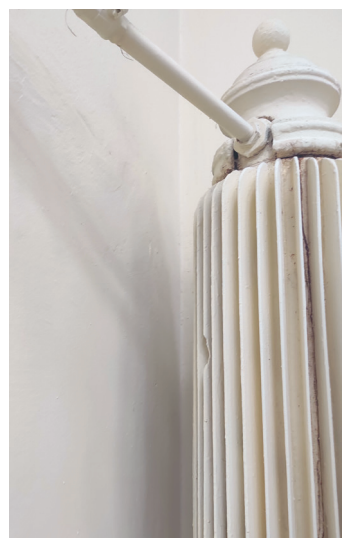
Действующий радиатор отопления в читальном зале (фото И. А. Кузнецовой, 2024 г.)
